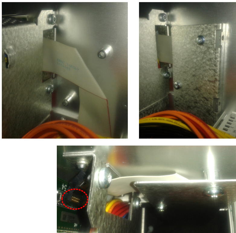
Abb. 3-8 Verbindung des Flachbandkabels mit der Backplane. Der Gegenstecker ist rot eingekreist.
