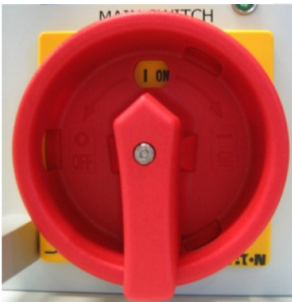
Switch utama (MAIN SWITCH)
