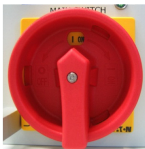
Hlavný vypínač (MAIN SWITCH)
