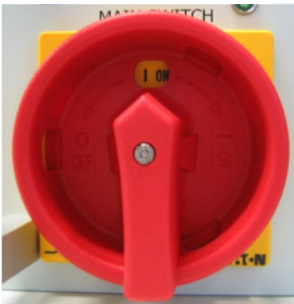
Công tắc chính (MAIN SWITCH)
