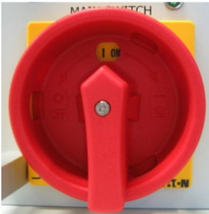
メインスイッチ (MAIN SWITCH)
