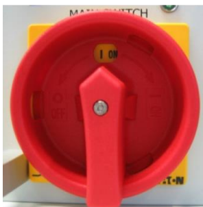
Glavna sklopka (MAIN SWITCH)
